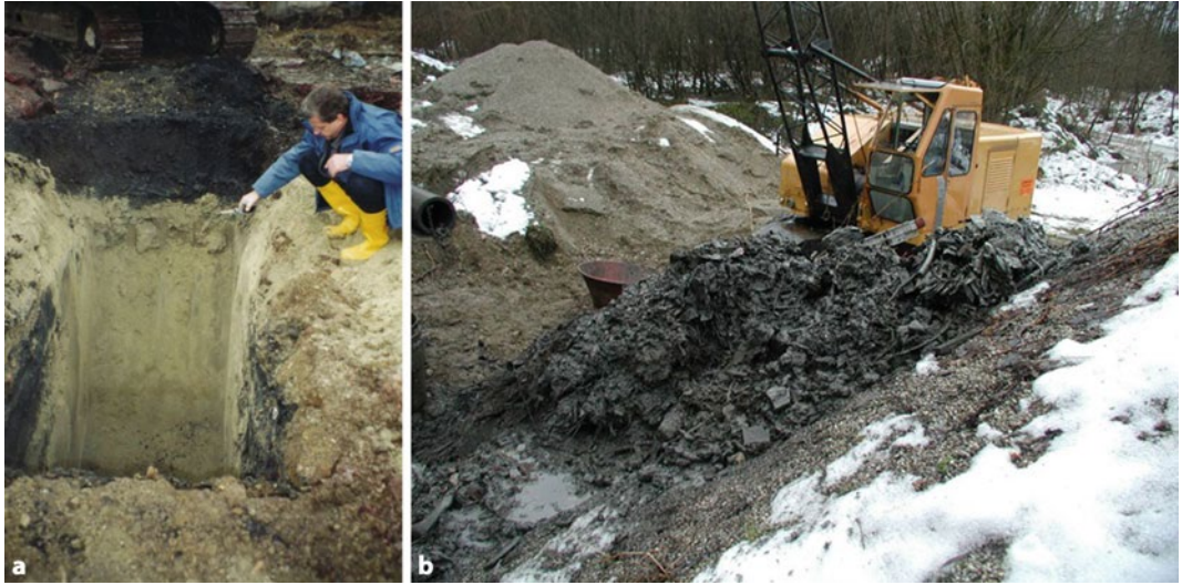
■ Abb. 7.9a,b Heterogenität von Böden entscheidet über die Probenahme-strategie in der Altlastenpraxis. Bei homogenen Böden wie in a erfolgt die Probenahme soweit möglich nach organoleptischem Befund (Geruch, Farbe) wie hier aus Baggerschürfen oder auch aus Bohrkernen; b zeigt eine Greiferbohrung innerhalb einer ehemaligen Hausmülldeponie. Die sehr heterogenen Verhältnisse erfordern die Entnahme großer Abfallmengen, um eine repräsentative Probenahme zu gewährleisten
